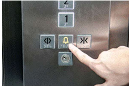
Les lignes de sécurité d'ascenseur
