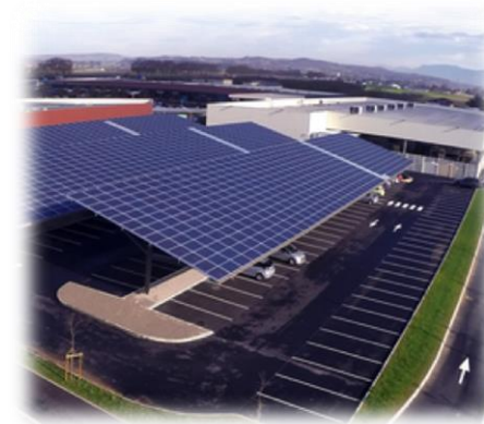
Ombrières de parking (source : Eco Solution Energie)
